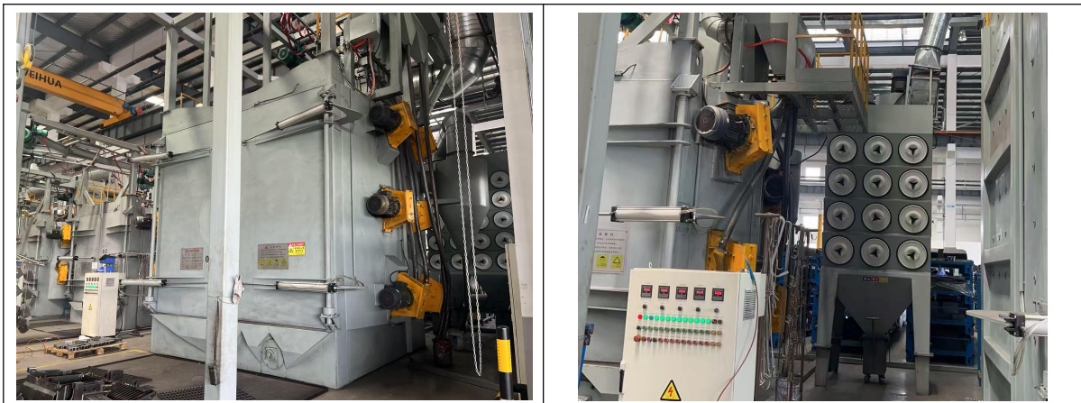
图 4-6 抛丸粉尘收集处理装置
