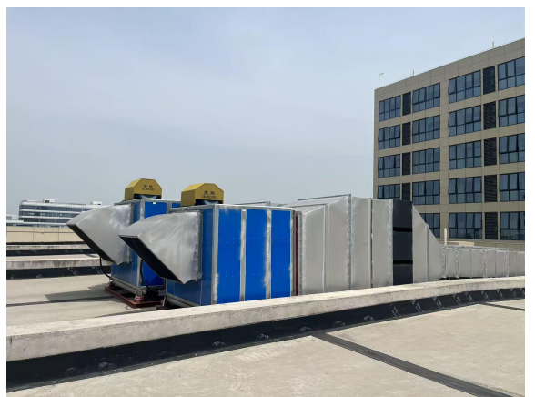
图 4-14 食堂油烟废气处理装置
