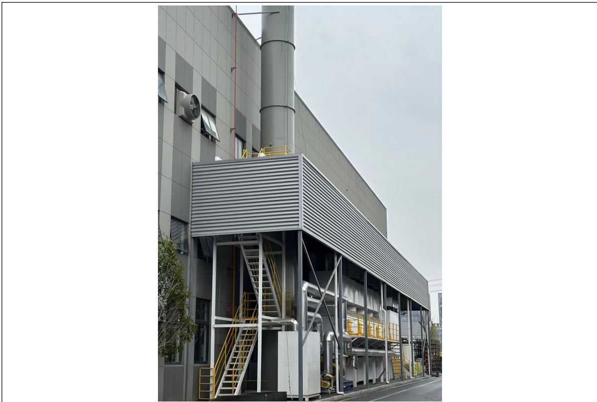
图 4-12 油漆处理废气收集处理装置
