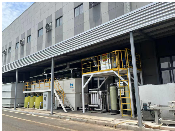
图 4-3 自建污水站及其废气处理装置
