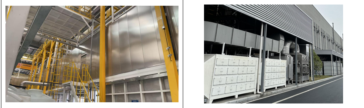
图 4-8 电泳、喷塑及其前处理废气收集处理装置
